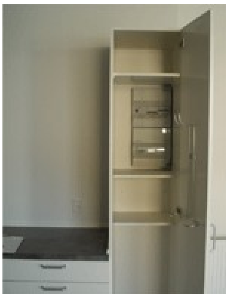
Figur 3, ulovligt installeret tavle.
