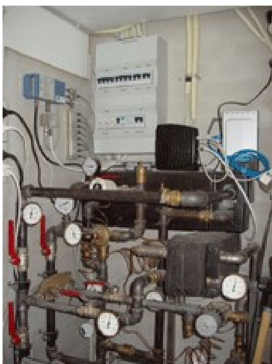
Figur 1, ulovligt installeret tavle.
