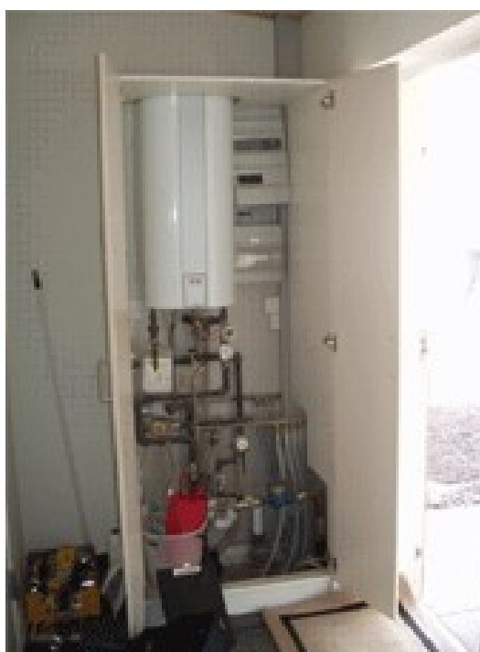
Figur 2, ulovligt installeret tavle.
