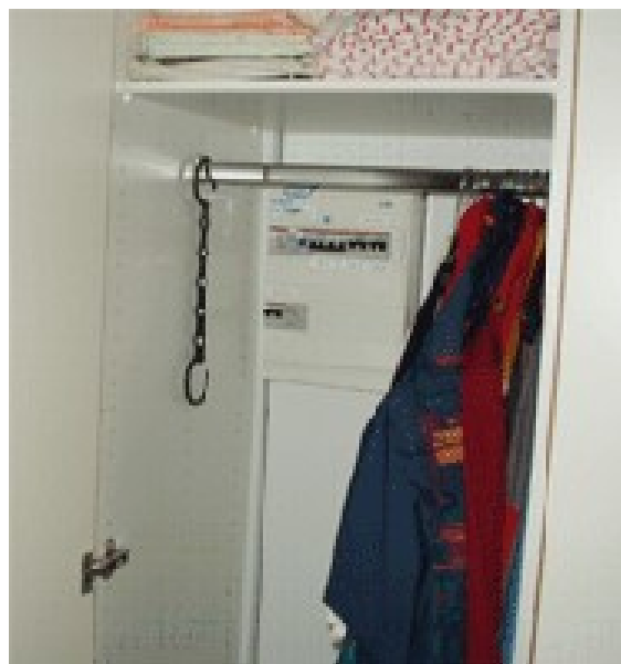
Figur 4, ulovligt installeret tavle.
