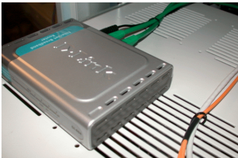
En router monteret på en udtræksskuffe.
