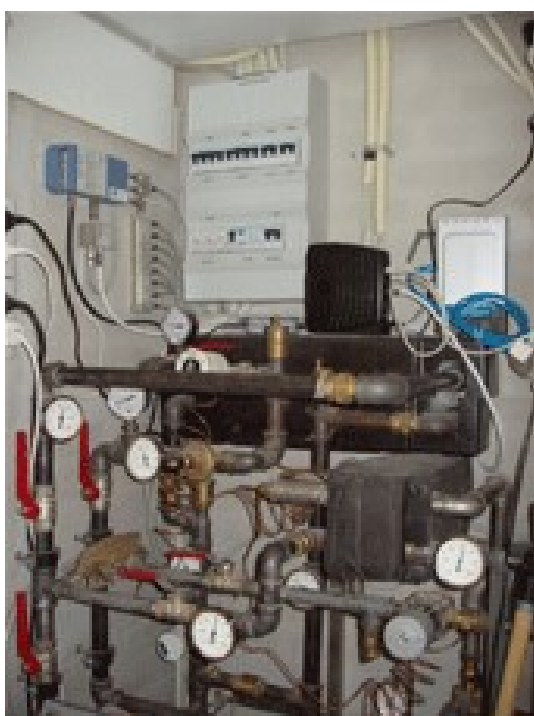
Figur 17, ulovligt installeret tavle.
