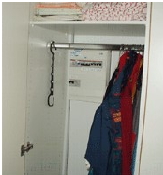
Figur 20, ulovligt installeret tavle.
