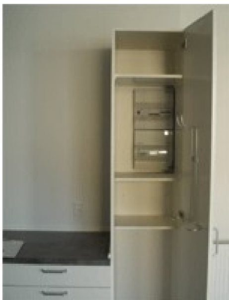
Figur 19, ulovligt installeret tavle.
