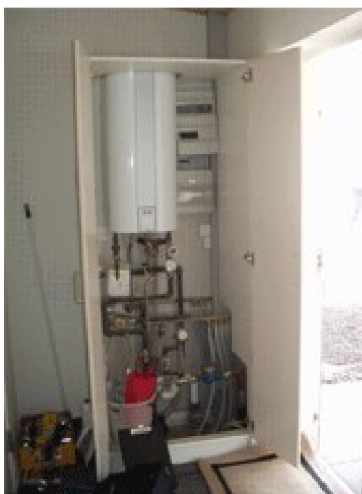
Figur 18, ulovligt installeret tavle.
