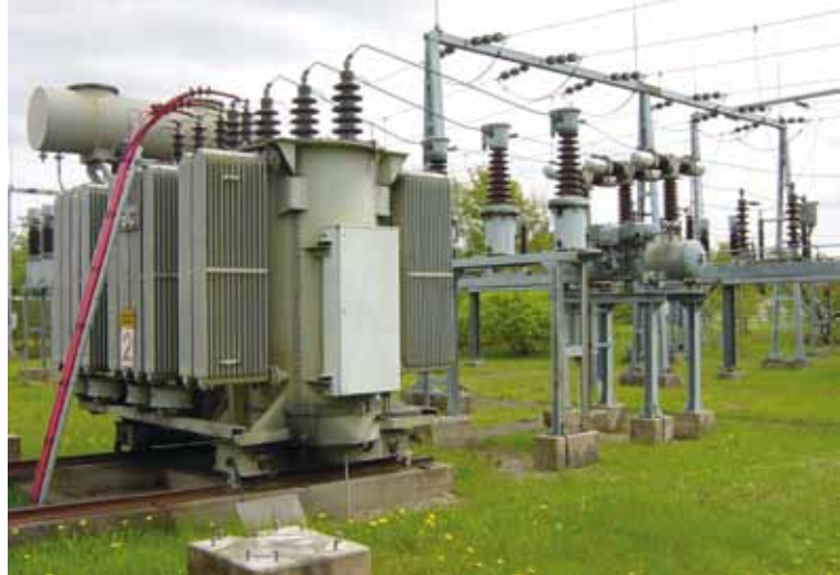
En 132/50 kV transformator.
