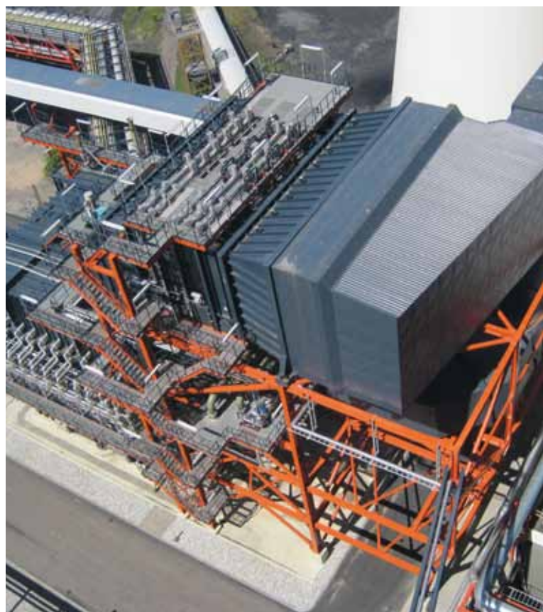
Afsvovlningsanlæg på Asnæsværket
