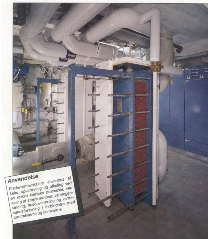
Figur 43: Eksempel på en veksler i et stort fjernvarmetilslutningsanlæg
