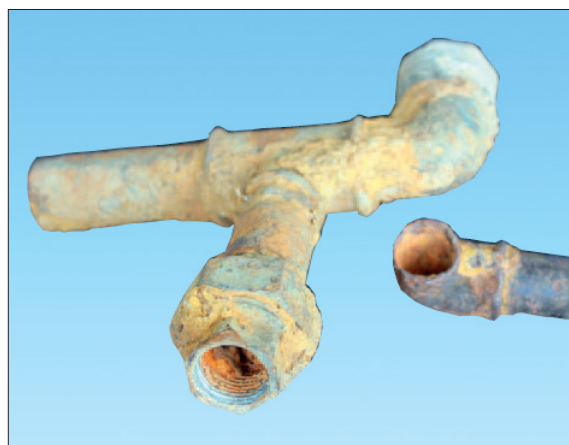
Varmforzinket stålrør med tydelige korrosionsskader
