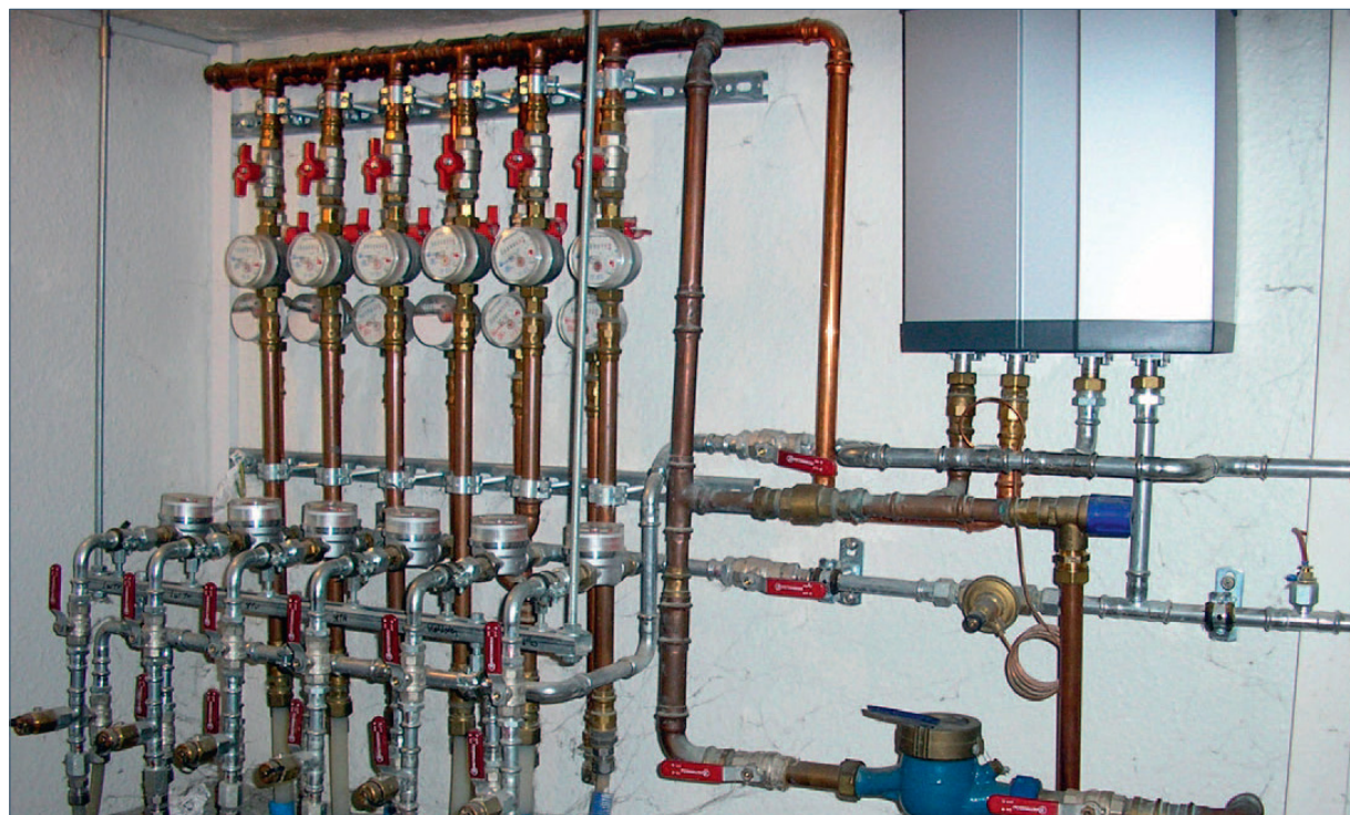
Vand- og varmeinstallation opbygget pænt og overskueligt
