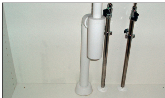
Køkkenskab med mekaniske koblinger i fodsparket, hvor det ikke er muligt at konstatere utætheder
