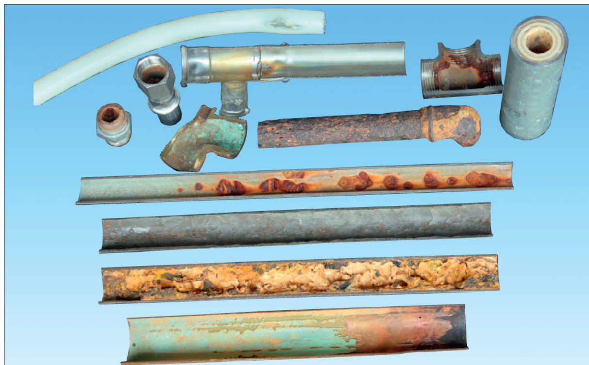
Typiske materialer i brugsvandssystemer med skader
