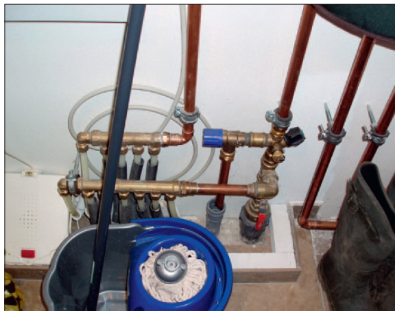
Sikkerhedsventil i parcelhus korrekt udført synligt over tragt eller lignede.
