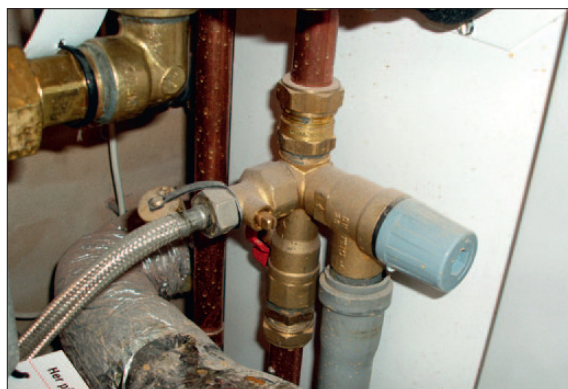
Overløbsledningen fra sikkerhedsventilen forkert udført, idet udløbet ikke er synligt
