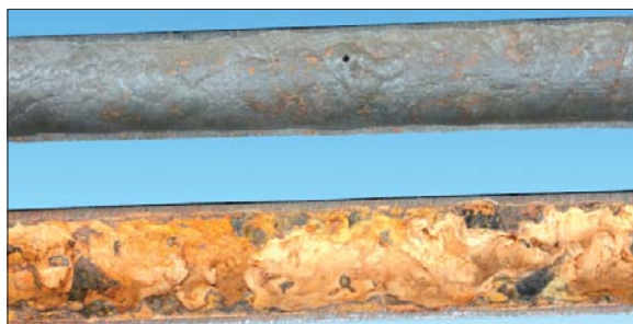
Typiske korrosionsskader i varmforsinkede stålrør i blødt vand, hvor varmforsinket stål har vanskeligt ved at opbygge gode beskyttende belægninger.
