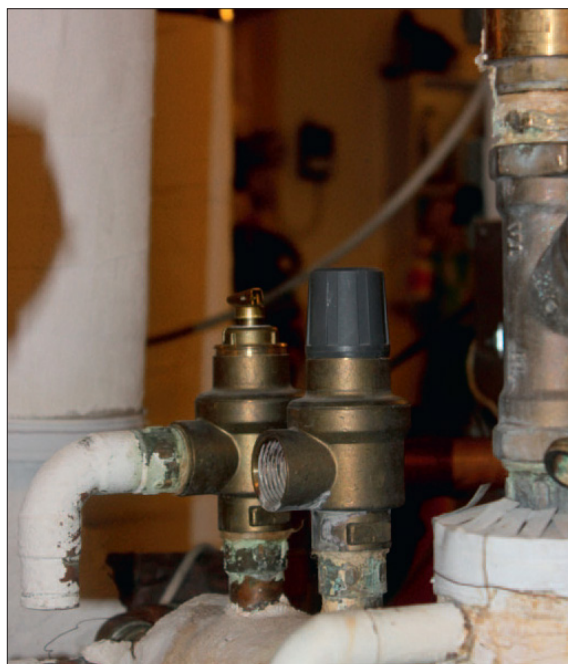
Ulovlig udført sikkerhedsventil uden overløbsledning. Sikkerhedsventilen kan forårsage alvorlige personskader
