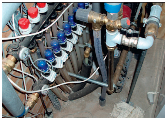
Sikkerhedsventil forkert monteret, idet der er monteret en slange på sikkerhedsventilen og overløb er ført direkte i afløb.
