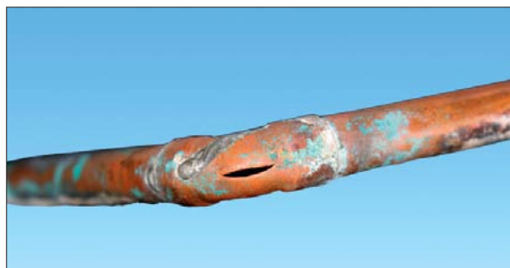
Eksempel på ekspansionsbrud i kobber som følge af fastspænding
