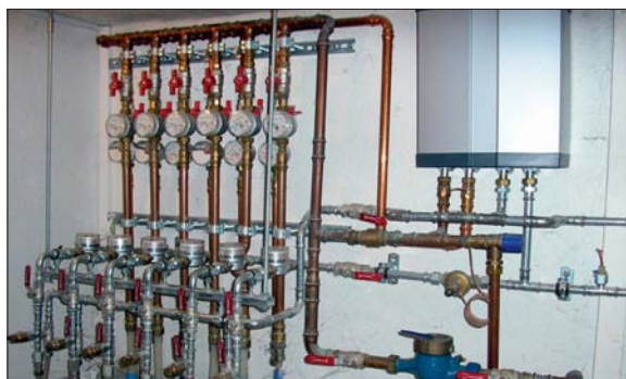
Et pænt og overskueligt opbygget anlæg med afspærringsventiler
