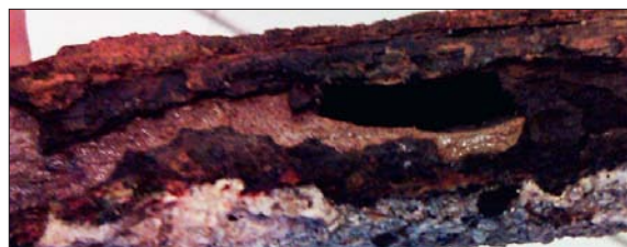
Eksempler på korroderede varmforzinkede stålør, der har været indstøbt
