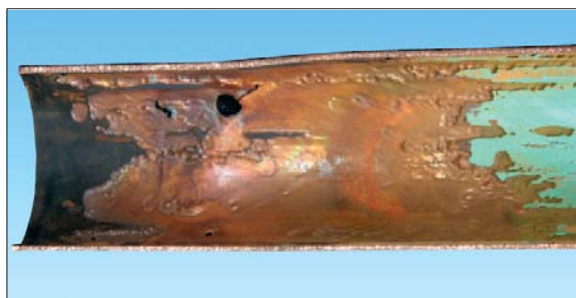
Eksempel på turbulenskorrosion i kobberrør
