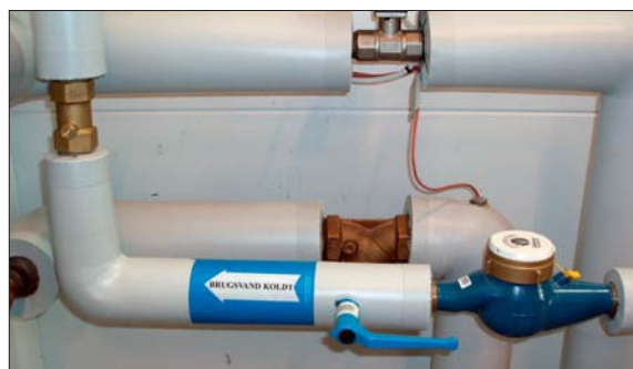
Isolering koldt vandsledning med tydelig rørmærkning. Kontraventilen burde isoleres med tydelig markering af, hvor den sidder
