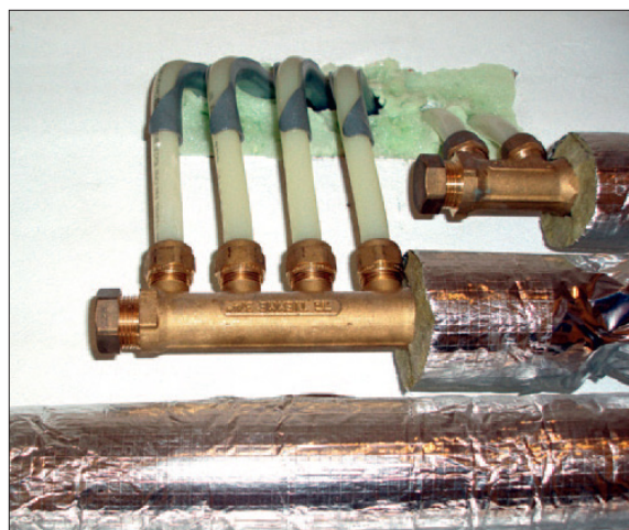
Fordelerrør skal også isoleres
