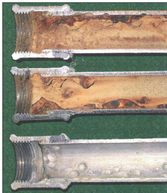
Øverst: Varmtforzinkede stålør efter ca. 5 år med hårdt brugsvand med højt saltindhold. Midten: Kobberafgivelse fra fordelerrør af messing har fremmet skaderne. Nederste stålør er belægningsene i røret afsyret og viser mange utætheder som følge af grubbetæring. Kilde: SBI anvisning 227. Korrosion i vvs-installationer.
