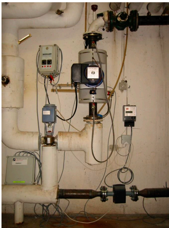
Figur 3. Præfabrikeret isoleringskappe på cirkulationspumpe
