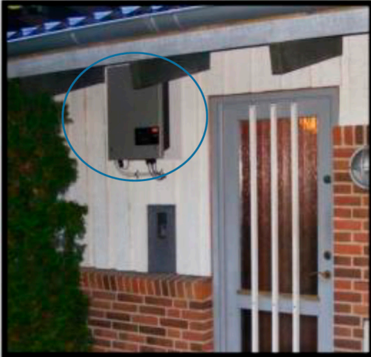
Figur 7. Eksempel på udendørs monteret inverter (Foto: Sikkerhedsstyrelsen)
