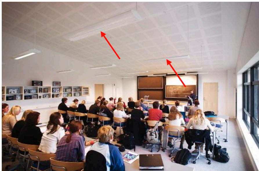
Figur 12. Zoneopdeling af belysningsanlæg. Armaturerne i højre side af lokalet er slukkede mens armaturerne til venstre er tændt. (Kilde: https://installator.dk/store-besparelser-med-lysstyring )
