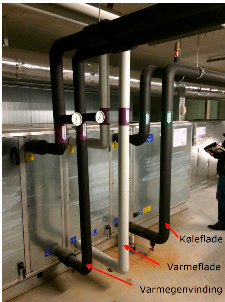
Figur 1. Komfortanlæg med varmegenvinding samt varme- og køleflade
